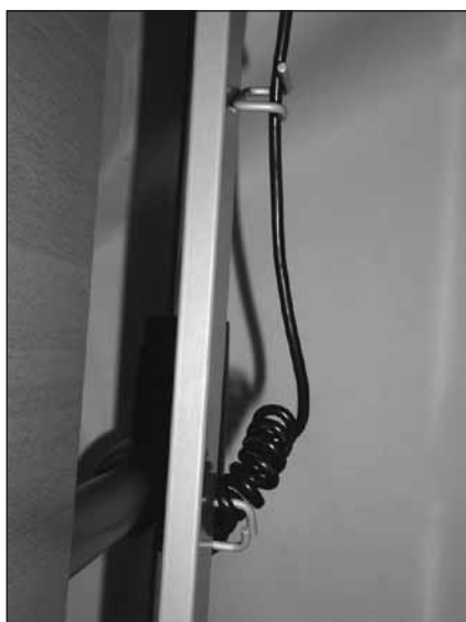
Câblage du moteur du panneau de lit (tête).
